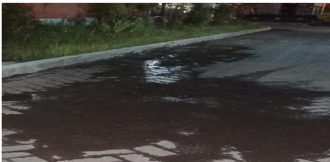
Gambar 1. Kondisi Paving karena Luapan Air Sungai
