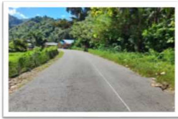
Gambar 20. Kondisi Permukaan Jalan Bilo-Tambun Segmen 1
