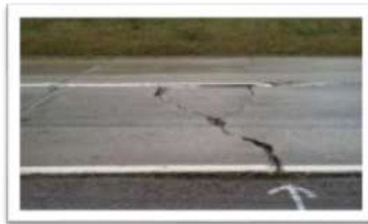
Gambar 4. Retak Sambungan Bahu dan Perkerasan (Edge Joint Crack) Sumber: Bina Marga No.03/MN/B/1983
