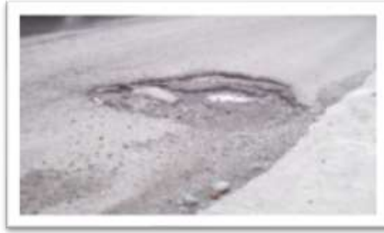
Gambar 14. Lubang (Potholes) Sumber: Bina Marga No.03/MN/B/1983
