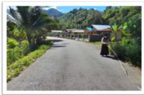
Gambar 21. Kondisi Permukaan Jalan Bilo-Tambun Segmen 2
