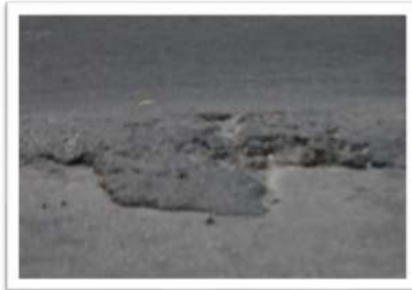
Gambar 17. Kegemukan (Bleeding / Flushing) Sumber: Bina Marga No.03/MN/B/1983
