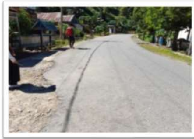
Gambar 22. Kondisi Permukaan Jalan Bilo-Tambun Segmen 3
