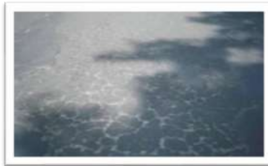
Gambar 15. Pelepasan Butir ( Raveling ) Sumber: Bina Marga No.03/MN/B/1983
