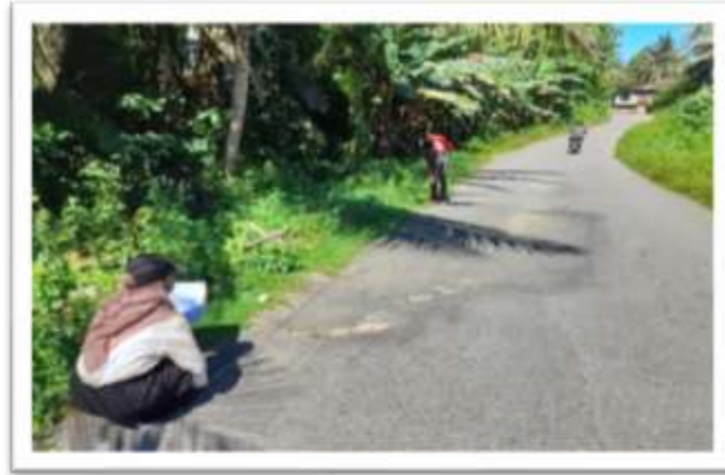
Gambar 24. Kondisi Permukaan Jalan Bilo-Tambun Segmen 5
