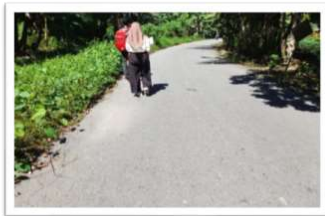
Gambar 25. Kondisi Permukaan Jalan Bilo-Tambun Segmen 6
