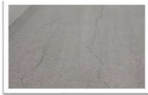
Gambar 1. Retak Halus atau Retak Garis (Hair Cracking)
