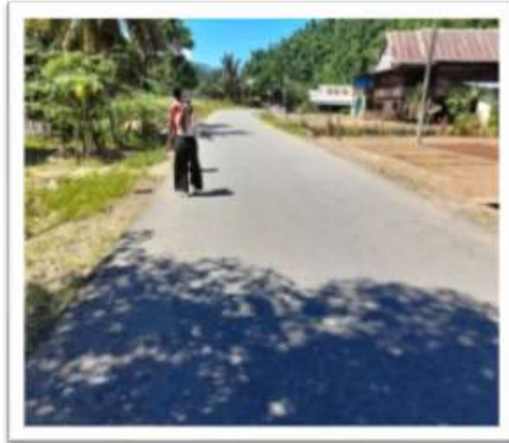
Gambar 28. Kondisi Permukaan Jalan Bilo-Tambun Segmen 9
