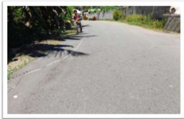
Gambar 26. Kondisi Permukaan Jalan Bilo-Tambun Segmen 7
