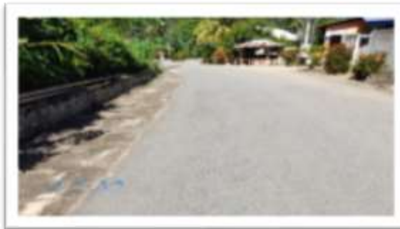
Gambar 27. Kondisi Permukaan Jalan Bilo-Tambun Segmen 8
