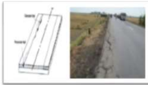
Gambar 3. Retak Pinggir (Edge Crack) Sumber: Bina Marga No.03/MN/B/1983
