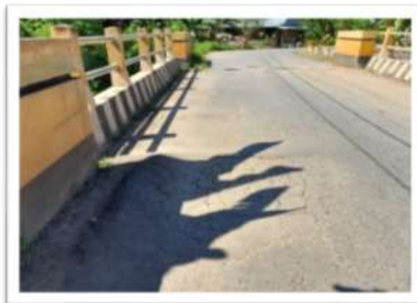
Gambar 23. Kondisi Permukaan Jalan Bilo-Tambun Segmen 4
