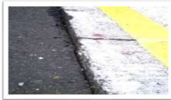
Gambar 6. Retak Sambungan Pelebaran Jalan ( Widening Crack ) Sumber: Bina Marga No.03/MN/B/1983
