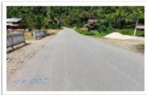
Gambar 29. Kondisi Permukaan Jalan Bilo-Tambun Segmen 9
