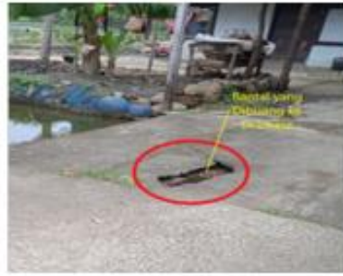
Gambar 3. Bantal yang dibuang pada saluran air yang menghambat aliran air
