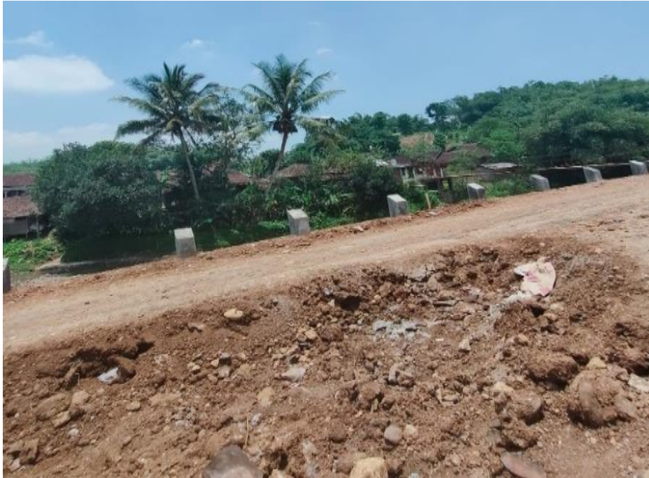
Gambar 1. Kondisi Jalan Sebelum TMMD Sumber: Kampung Banen RW 03
