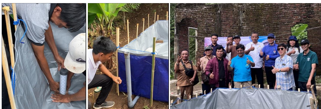
Gambar 4. Instalasi Pipa Saluran Pembuangan Sistem Tempurung Lutut
