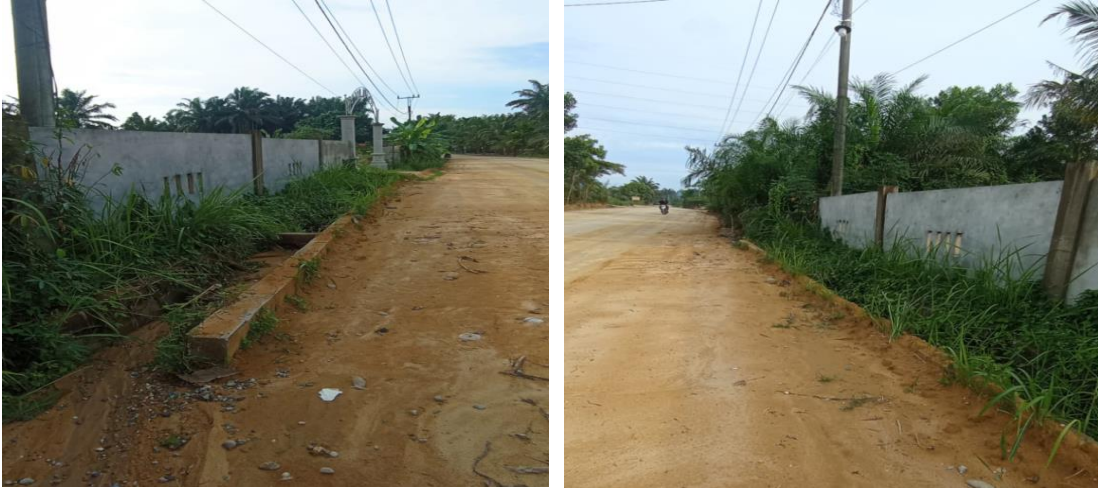
Gambar 1. Parit Beton di Jalan Perjuangan Desa Kesumbo Ampai Sumber : Dokumentasi Penulis, 4 Juni 2023
